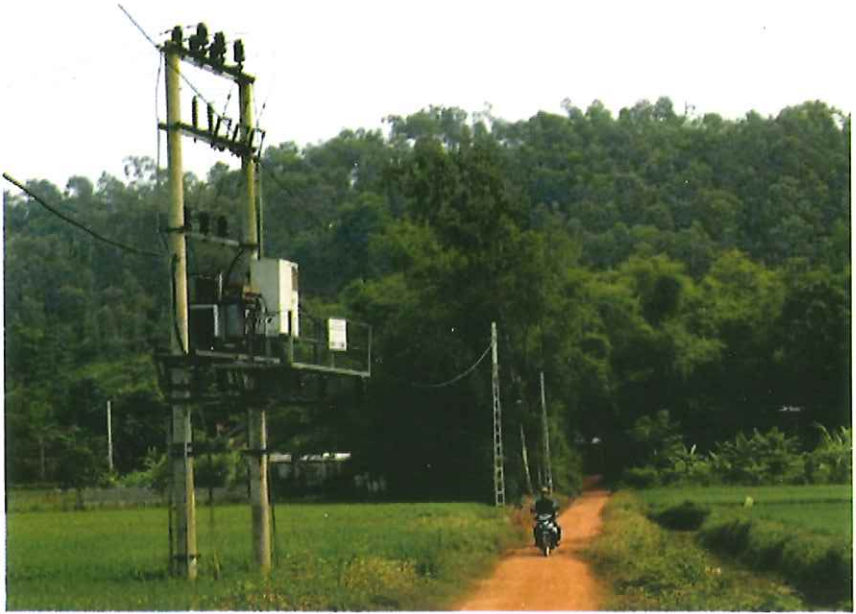
Trạm biến áp tại xã Cao Kỳ
