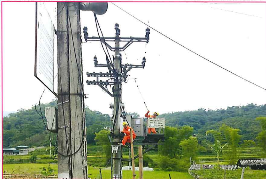
Trạm biến áp xã Cổ Linh (xây dựng năm 2005)
