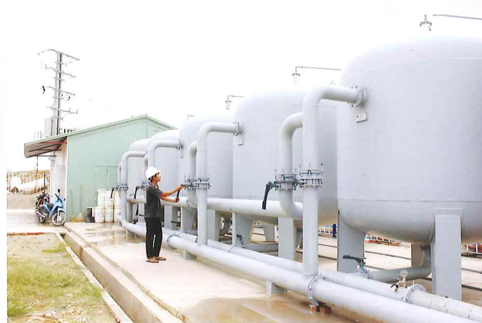
Hệ thống cung cấp nước với các trang thiết bị hiện đại.
